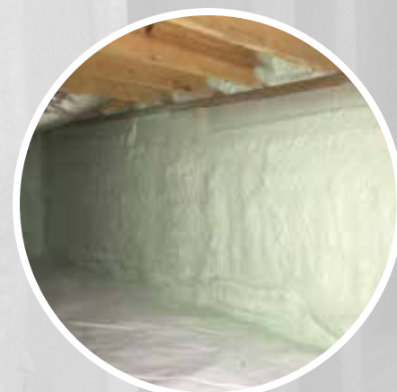
Espacios de acceso libre debajo de pisos
