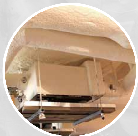
Conductos y penetraciones
